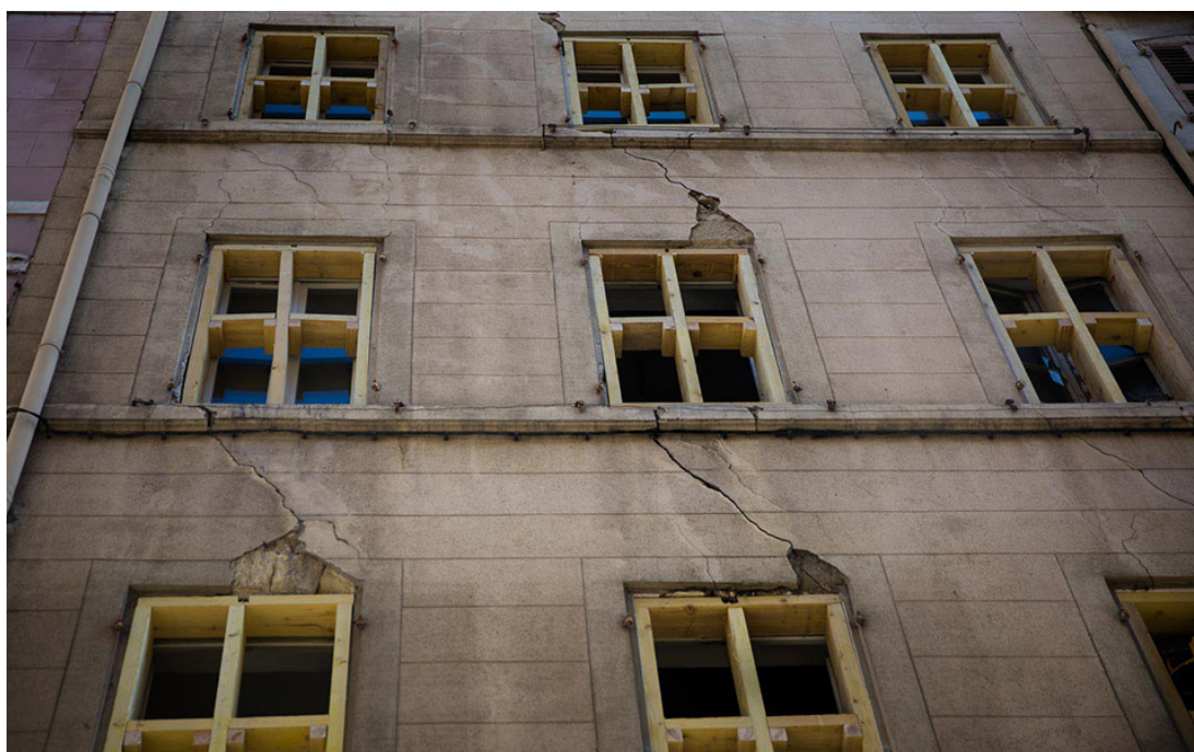
□Un immeuble rue Jean Roque à Marseille évacué de ses habitants, la copropriété a entamé des travaux, par Anthony Micallef□
